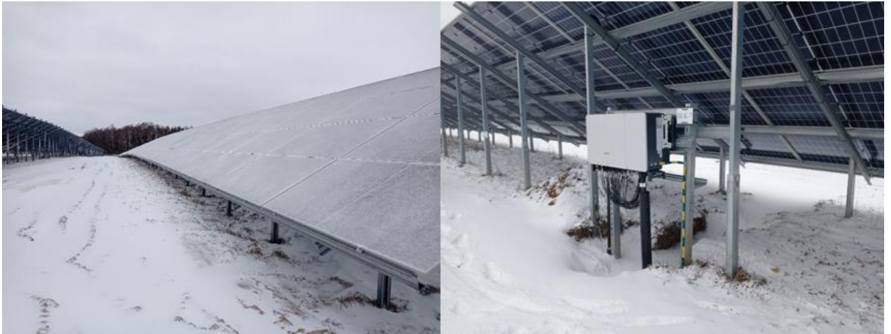
Pav. 48. Saulės elektrinė
