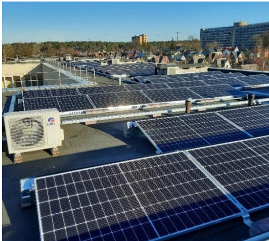
Pav. 41. Saulės elektrinė ant "Ryto" gimnazijos stogo
