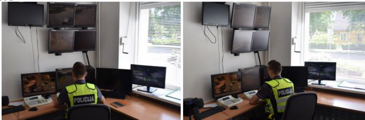
Pav. 116. Vaizdo kamerų stebėjimas komisariato patalpose
