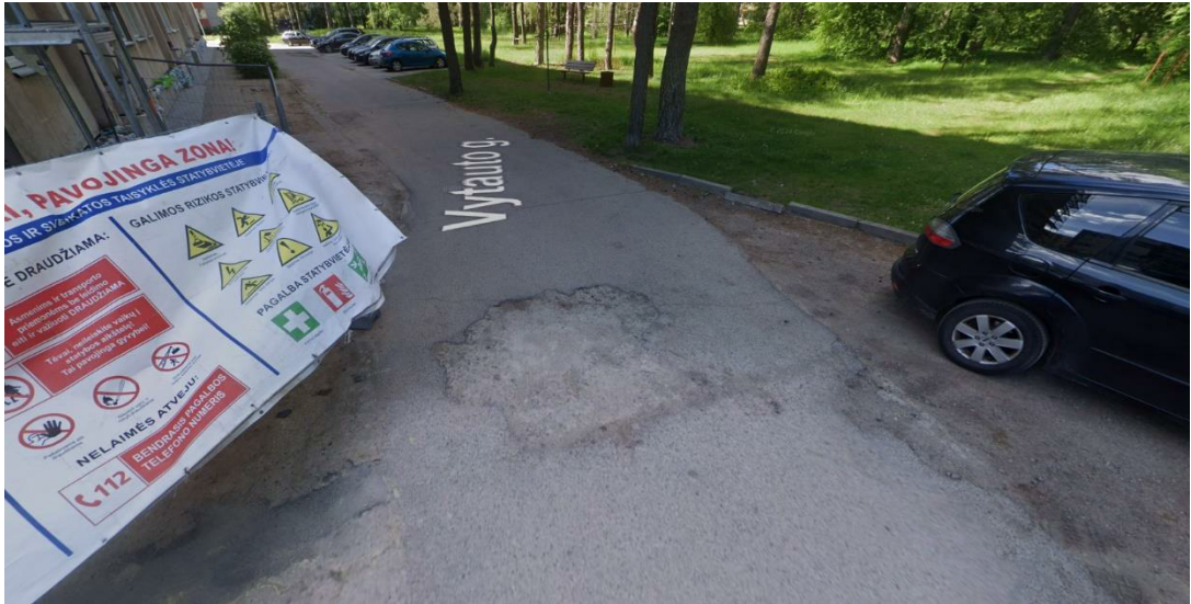
2.2pav. Esamos aikštelės dangos būklė-1
