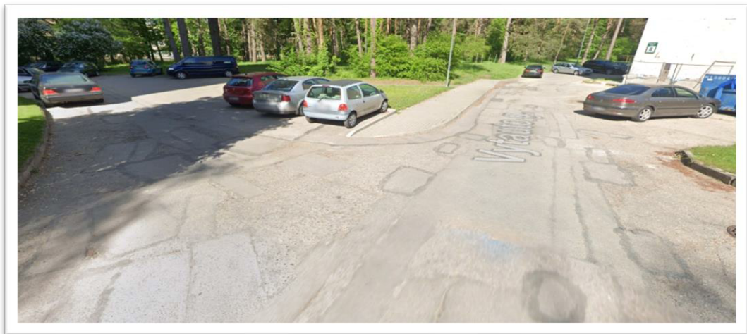
2.3pav. Esamos aikštelės dangos būklė-2
